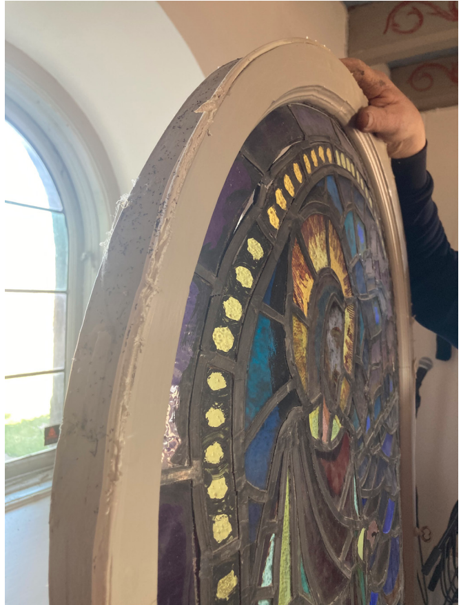
I ovankanten hade glasbitarna börjat krypa ur blyspröjsningen så att glipor uppstod mellan glas och spröjs.
